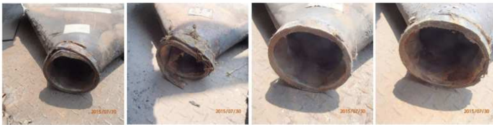
【ファンブレードを取り外した状態で固定リング側より見た写真】
