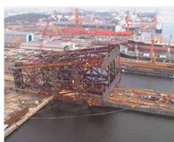
ジャケット（脚部）の積み出し 事前に現場に設置し、生産井を掘削
